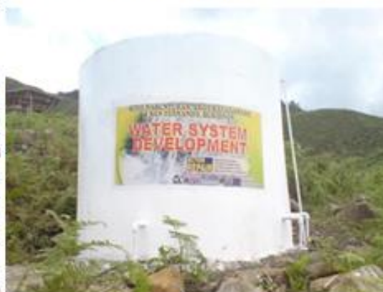
watertank van het drinkwatersysteem.
